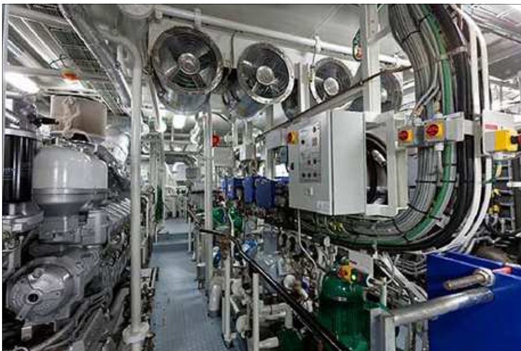
Συγκρότημα ανεμιστήρων σε μηχανοστάσιο σκάφους
