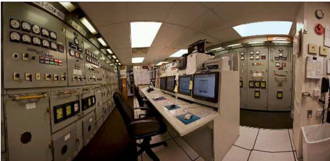
Αίθουσα ελέγχου μηχανής (engine control room) σύγχρονου σκάφους
