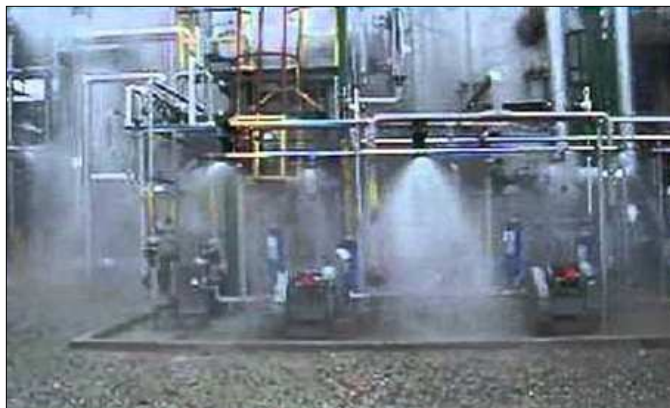
Σύστημα "Sprinkler" σε δοκιμή λειτουργίας του
