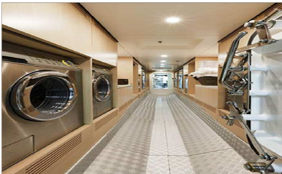
Χώρος Πλυντηρίων και στεγνωτηρίου
