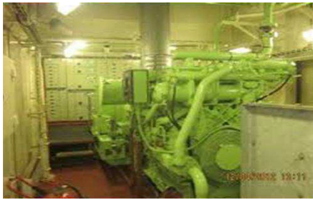
Γεννήτρια έκτακτης ανάγκης / Emergency diesel generator
