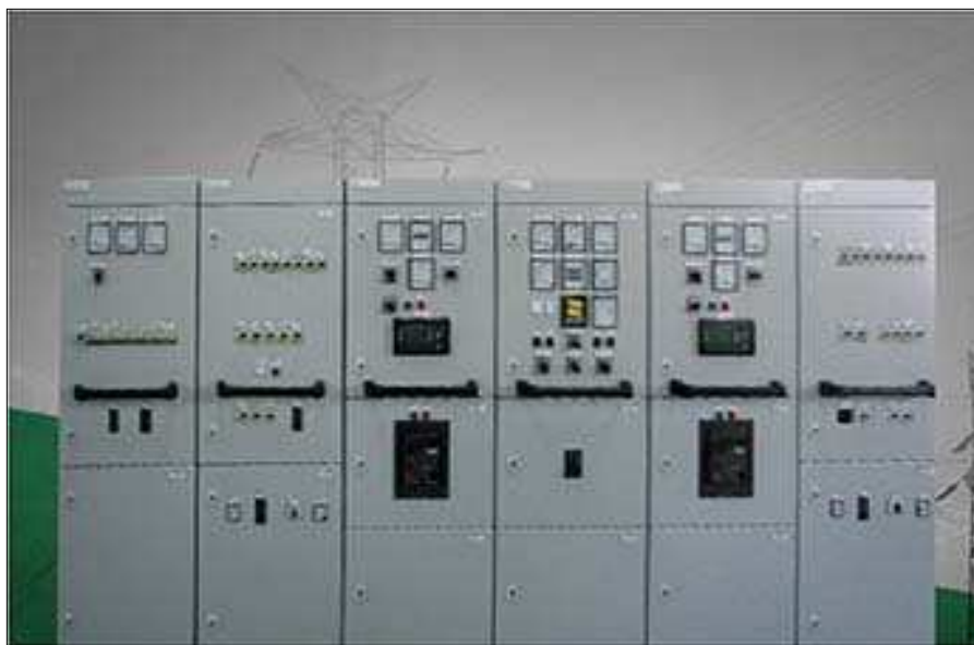
*Ηλεκτρολογικοί πίνακες ναυτικού τύπου ενός σύγχρονου συστήματος διανομής ηλεκτρικής ενέργειας σε ταχύπλοα σκάφη SUPER / MEGA YACHTS
