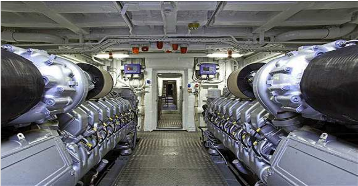
Εσωλέμβιες μηχανές σε μηχανοστάσιο σκάφους
